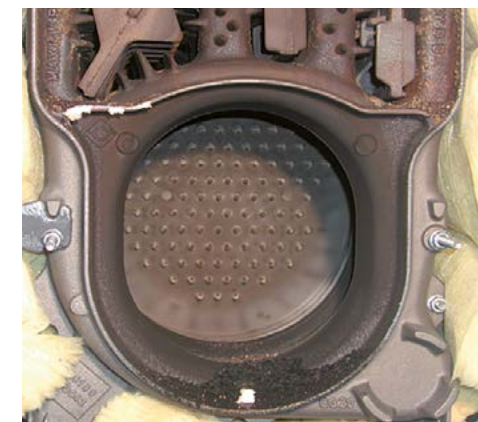
Brennkammer eines Kessels nach 1800 Stunden Laufzeit, der mit Ökoheizöl schwefelarm befeuert wird.
